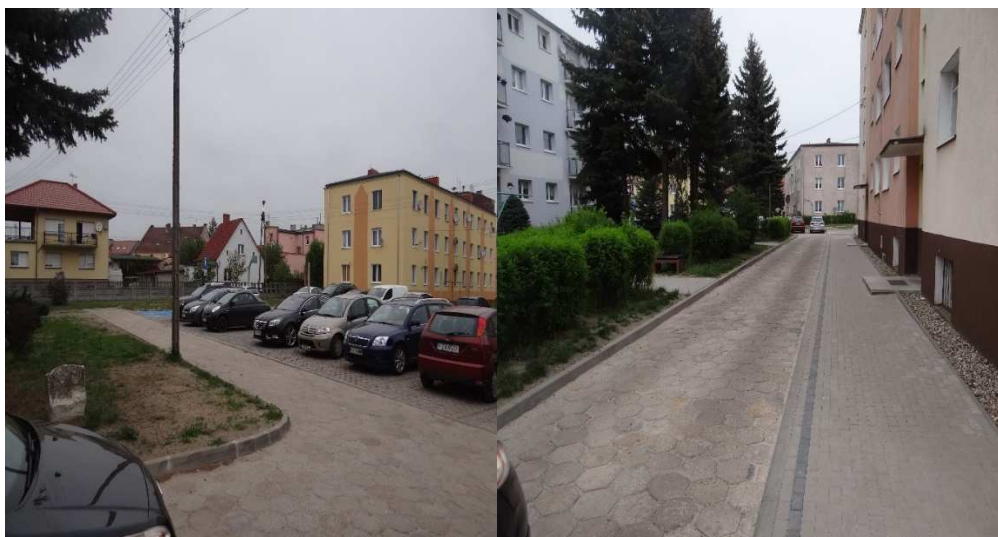
Fot. remont ciągu pieszo-jezdnego wraz z miejscami postojowymi pomiędzy blokami przy ul. Wąskiej i ul. XX Lečia
