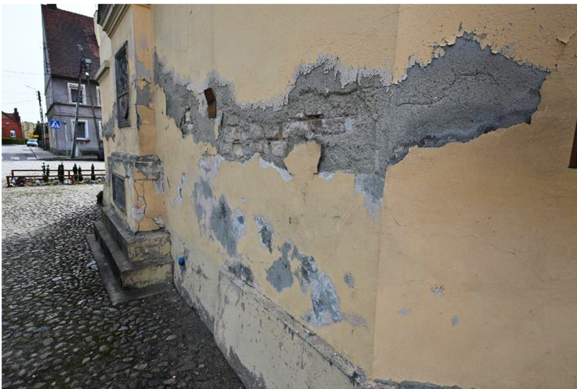
Fot. 10 Elewacja prezbiterium – widoczne uszkodzenia oraz ubytki tynków
