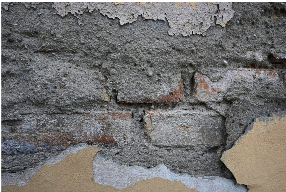
Fot. 12 Widoczne uszkodzenia i ubytki wypraw tynkarskich oraz ubytki w spoinowaniu muru
