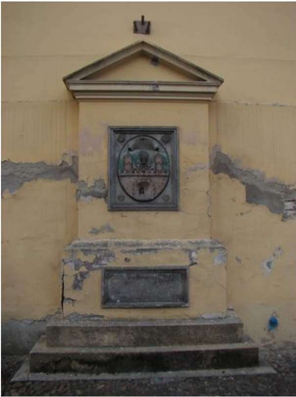
fot. 12: element architektoniczny z wykonanymi z piaskowca herbem miasta i dziś nieczytelną płytą inskrypcyjną, na południowej ścianie prezbiterium, widoczne odkrywki w tympanonie i zniszczenia tynku w strefie granicznej zawilgocenia
