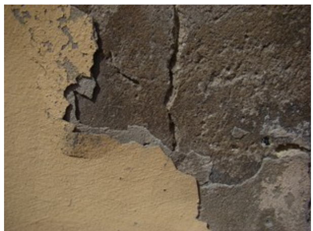
fot. 16: łuszczące się kolejne zacierki i uzupełnienia tynkarskie ściany w rejonie zniszczeń w strefie granicznej zawilgocenia, kumulującej przez wysychanie największą ilość soli
