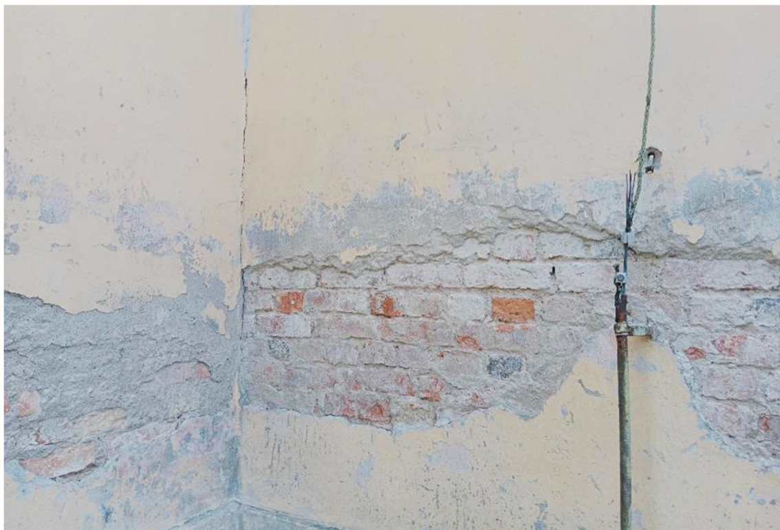
Fot. 14 Widoczne uszkodzenia i ubytki wypraw tynkarskich
