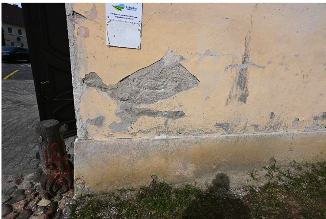
Fot. 8 Elewacja południowa wieży – widoczne ubytki oraz odspojenia tynków
