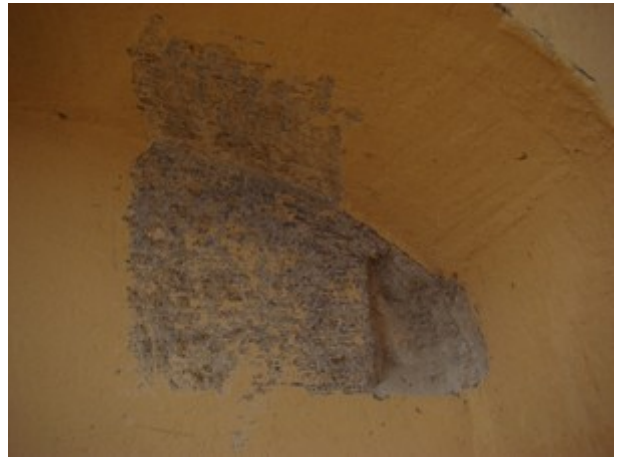
fot. 14: odkrywka na wyprawie tynkarskiej blendy nad bocznym wejściem do kościoła, zachodnia ściana północnego transeptu
