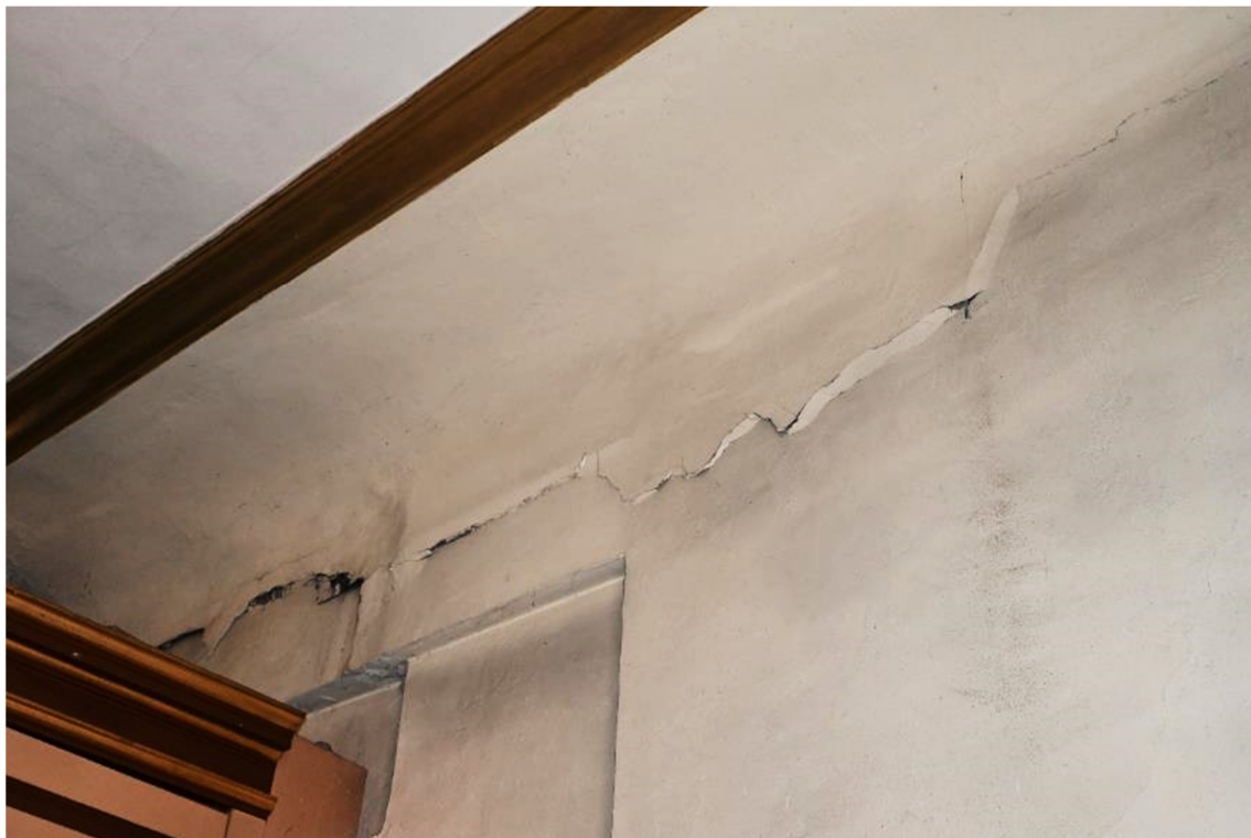
Fot. 23 Wnętrze kościoła – widoczne uszkodzenia w obszarze stropu nad chórem
