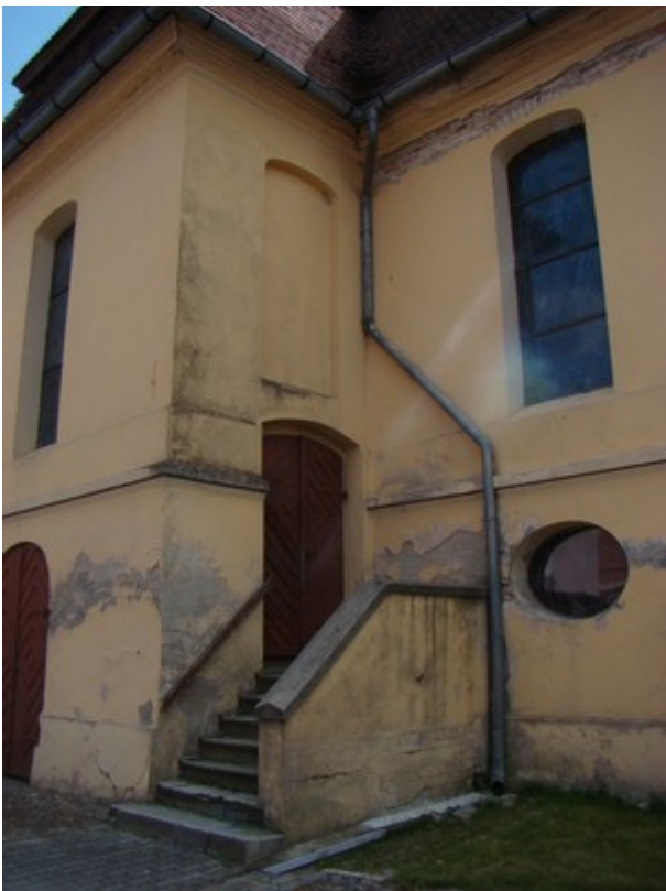
fot. 15: widok na północną część transeptu, widoczne wejścia boczne, strefa graniczna zawilgocenia i pas usuniętego tynku w miejscu osadzenia klamer wzmacniających ścianę korpusu (stopnie schodów z elementów prefabrykowanych jak po str. południowej)
