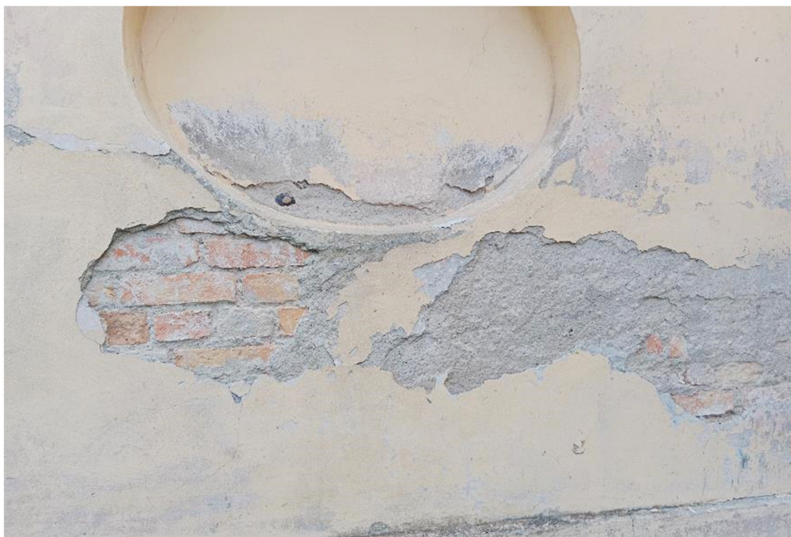
Fot. 13 Widoczne uszkodzenia i ubytki wypraw tynkarskich
