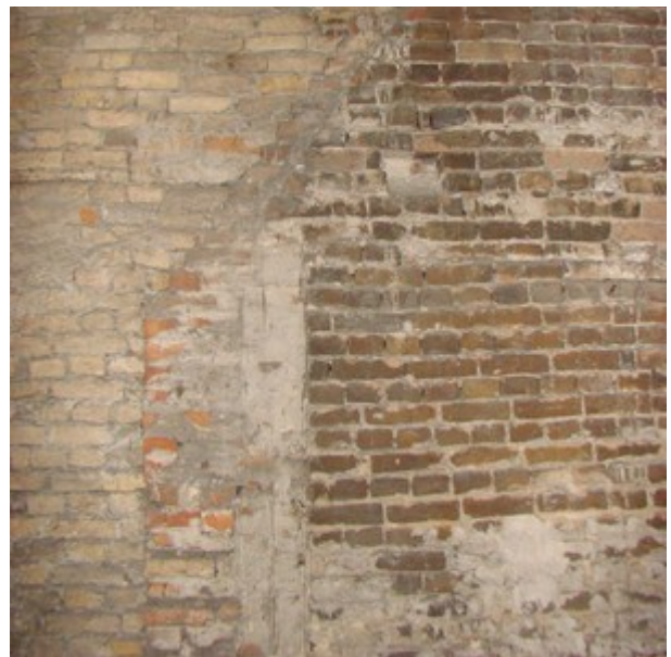
fot. 25: wewnętrzna strona szczytu po zachodniej stronie z widocznymi wtórnymi przemurowaniami
