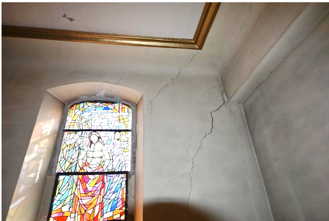
Fot. 24 Wnętrze kościoła – widoczne uszkodzenia w obszarze ścian przy chórze
