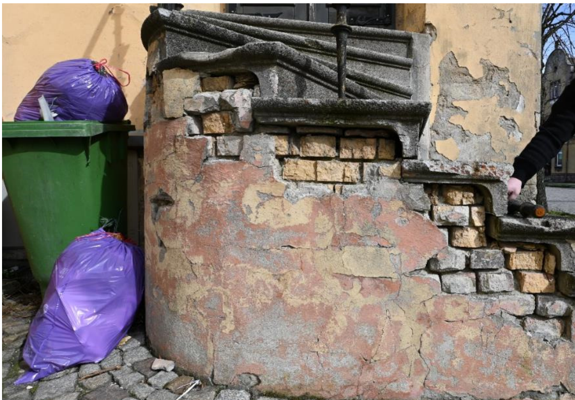
Fot. 17 Uszkodzenia schodów zewnętrznych w obszarze południowej części budynku
