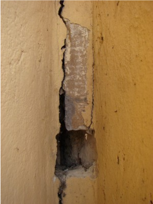
fot. 18: głęboka odkrywka sondażowa i odkrywka warstw malarskich na linii połączenia brył wieży i nawy
