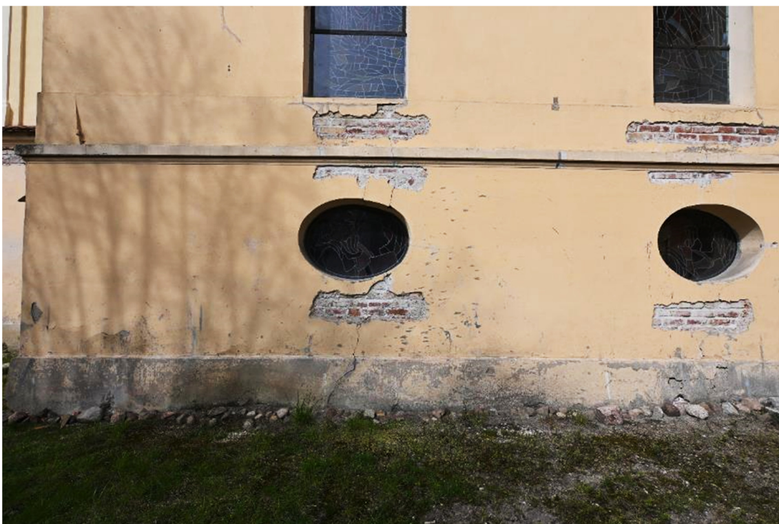
Fot. 9 Elewacja południowa nawy głównej – widoczne uszkodzenia cokołu oraz ubytki tynku pozostałe po wcześniej prowadzonych pracach naprawczych
