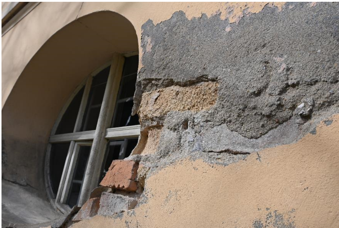
Fot. 11 Widoczne uszkodzenia oraz ubytki wypraw tynkarskich, prawdopodobnie wprowadzanych w różnych fazach remontowych
