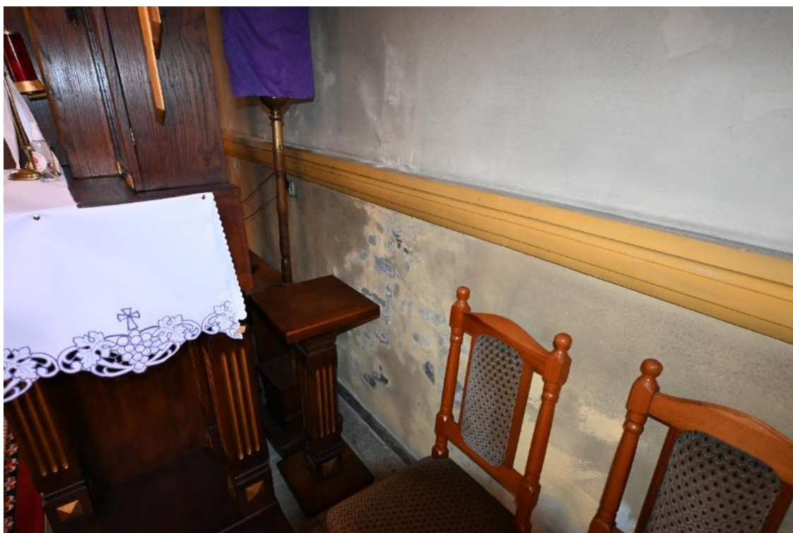
Fot. 21 Wnętrze kościoła – widoczne zawilgocenie ścian w obszarze przyziemia
