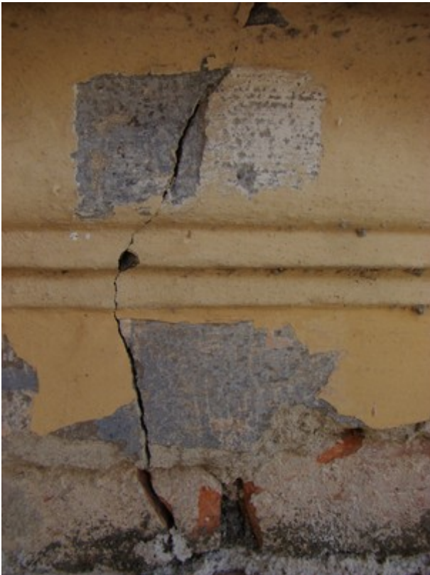
fot. 19: odkrywka na dolnej części profilu na północnej ścianie wieży (będącego przedłużeniem gzymsu koronującego z korpusu) i wyprawie tynkarskiej ściany (poniżej), widoczna lokalnie wyraźnie zachowana niebieska malatura
