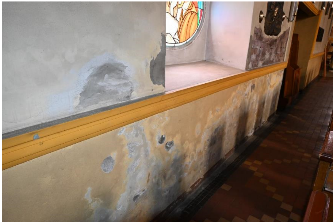
Fot. 20 Wnętrze kościoła – widoczne zawilgocenie ścian w obszarze przyziemia
