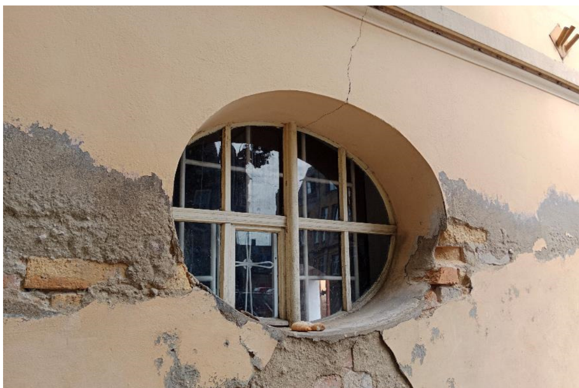
Fot. 15 Uszkodzenia w obszarze otworu okiennego – widoczne ubytki tynków oraz pęknięcie nadproża
