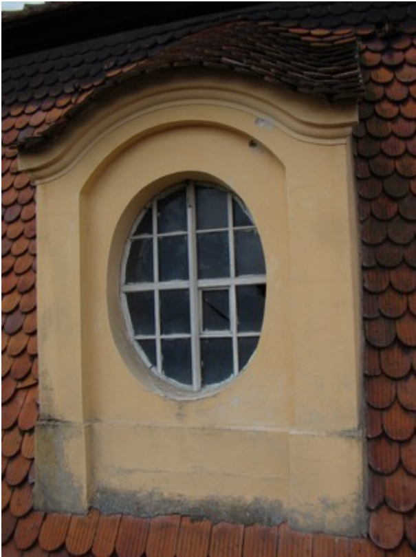
fot. 3: okno mansardowe po stronie wschodniej na osi kościoła, widoczne miejsca pobrania próbek i odkrywki
