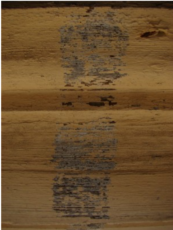
fot. 6: odkrywka na drewnianej części profilu gzymsu koronującego po stronie wschodniej, widoczny pogłębiony przez procesy wietrzeniowe rysunek drewna
