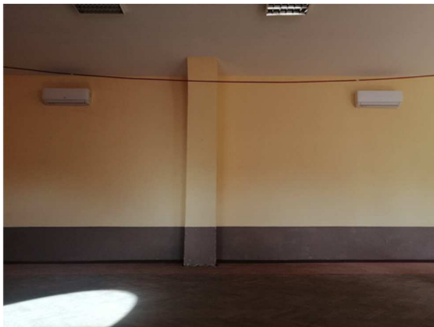
Fot. Klimatyzatory na świetlicy wiejskiej w miejscowości Bronice
