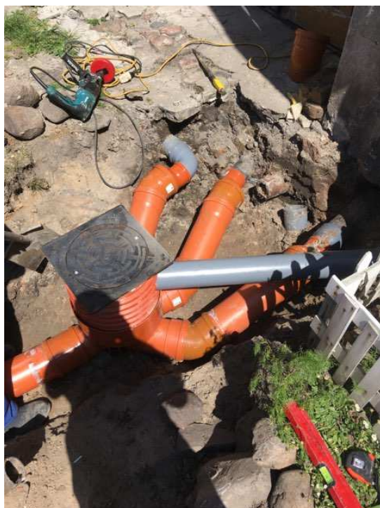
Fot. Wykonanie przyłączy kanalizacyjnych do budynków mieszkalnych w Jasieniu przy ul. Kościuszki, ul. Waryńskiego
