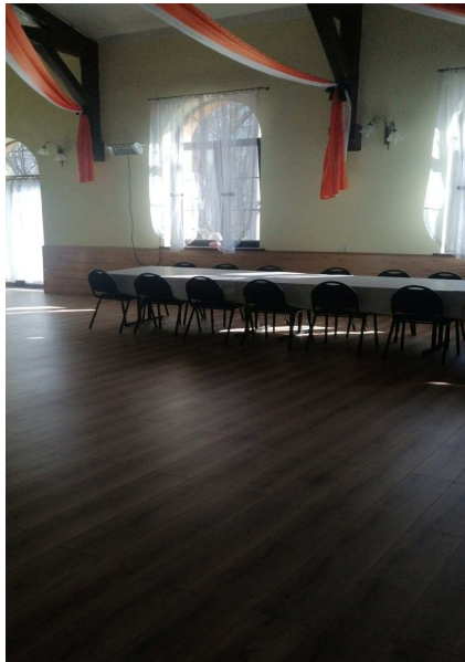
Fot. Podłoga w świetlicy wiejskiej w Lisiej Górze.
